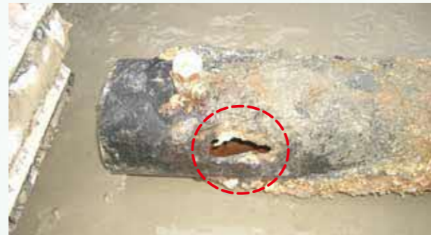
写真 - 古い水道管に開いた穴
