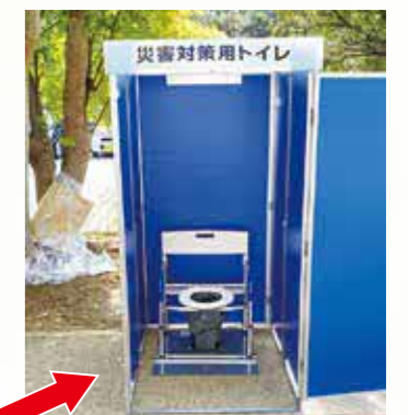
マンホールトイレ
