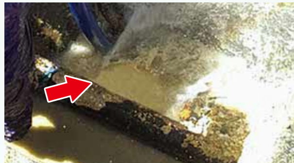
写真 - 古い水道管からの漏水状況
