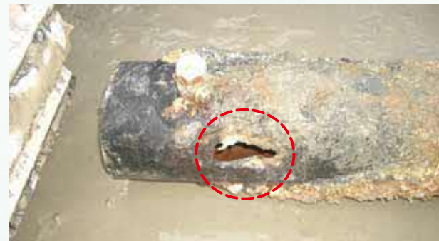
写真 - 古い水道管に開いた穴
