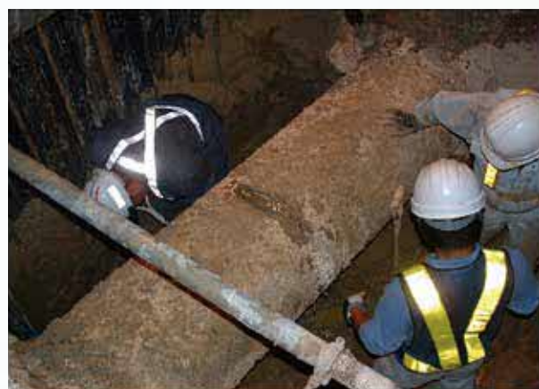
写真 - 耐震性が無い古い水道管
