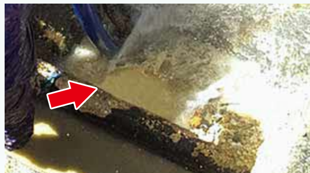
写真 - 古い水道管からの漏水状況
