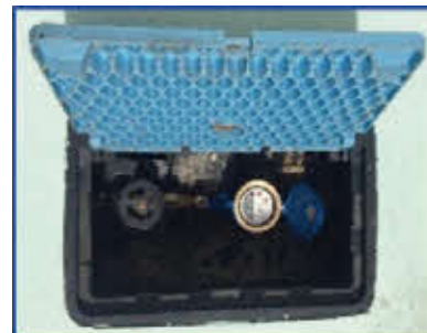
水道メーターボックス
