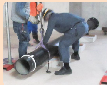
口径 250mm の配水管
