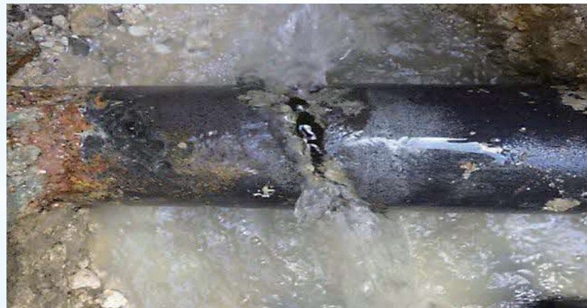
古い水道管からの漏水状況
