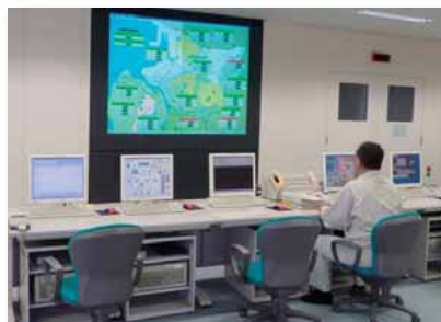
上水道監視室の様子
