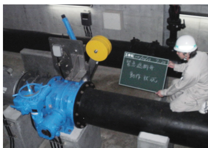
緊急遮断弁確認
