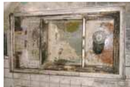
清掃前のグリース阻集器 グリース阻集器が十分に機能しないと、汚水管などで油分が固まり、排水ができなくなってしまいます。
