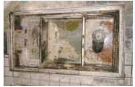
清掃前のグリース阻集器 グリース阻集器が十分に機能しないと、汚水管などで油分が固まり、排水ができなくなってしまいます。
