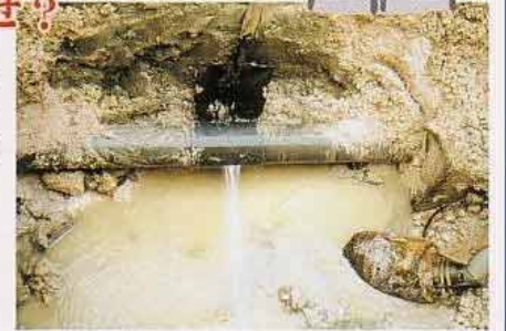
穴があいて水漏れした水道管
