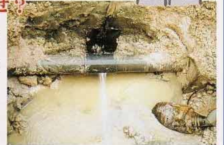
穴があいて水漏れした水道管
