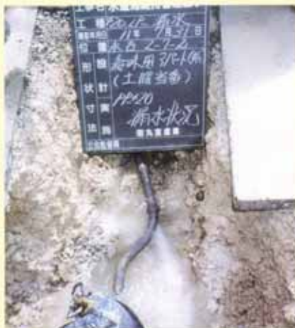
給水管漏水状況
