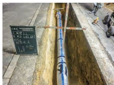
⑤ 新しい水道管布設 耐震性にも優れた新しい管を布設します。
