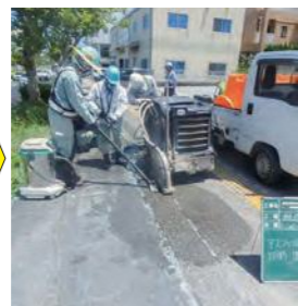
② アスファルト舗装切断 アスファルトカッターを使用します。
