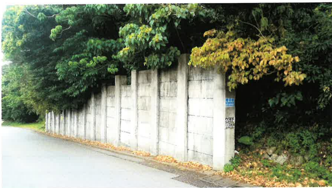
道路の傍の傾斜地崩落を防止するため設置した「自立型擁壁」
