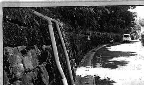
市道真地7号線は、真地小学校から真和志高校方面へ繋がる、市内でも数少ない急坂の道路である。通学路であり、生活道路でもある。左の石垣は建設からすでに50年は経過しているものと思われ、斜面から押されて膨らみと隙間ができています。その石垣を含む雑木林は私有地であるが、崖崩れ対策を自費で行うには巨額である。しかしその恩恵は地域住民が受けるのであれば、公共工事として対策すべきではないでしょうか。
