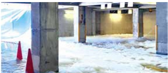
PFOS含有泡消火薬剤 (なは市民協働プラザ地下駐車場)
