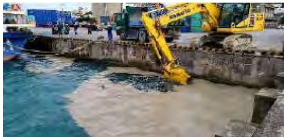
新港ふ頭に漂着した軽石(那覇港管理組合提供)
