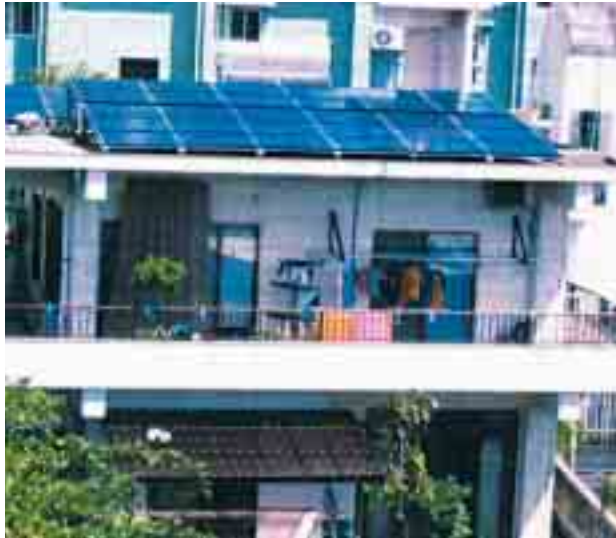
住宅用太陽光発電システム
