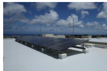
▼ 住宅に設置された太陽光パネル
