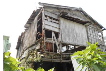
▼ 管理不全な空き家
