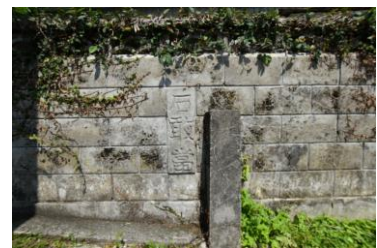
▼ 老朽化した道路沿いの ブロック塀
