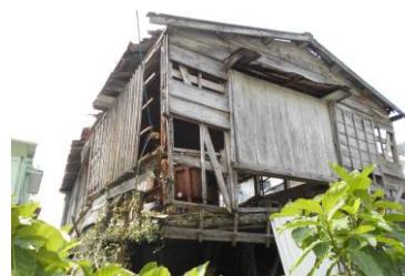
▼ 管理不全な空き家
