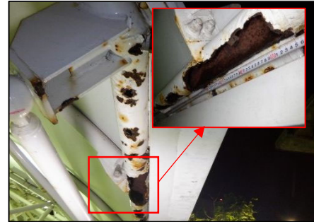
写真-1.4 県庁前駅 B 橋(自由通路) 屋根梁部の断面欠損
