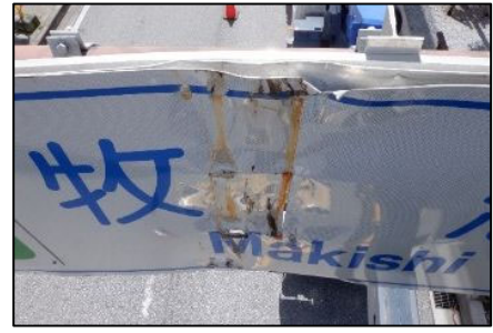
写真-1.2 Ⅲ判定 門型標識① 標識板の変形欠損(衝突痕)
