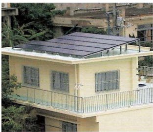
住宅用太陽光発電システム
