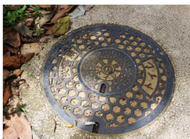
災害用マンホールトイレ（新都心公園） (出典：都市計画マスタープラン)
