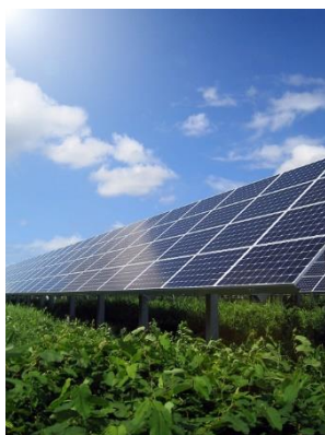
太陽光発電設備
