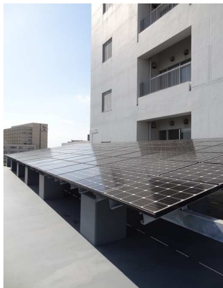
那覇市役所に設置している太陽光パネル
