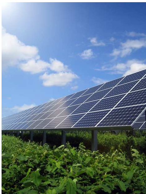
太陽光発電設備
