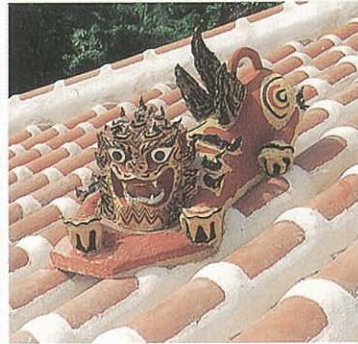
シーサー(屋根獅子) 工事の際に瓦のかけらとムチ(漆喰)で製作したもの
