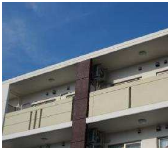
目隠し壁により室外機を隠した事例
