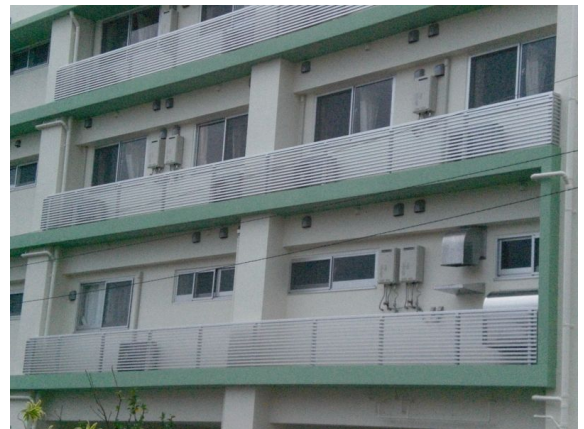
室外機を周囲から見えにくい位置に設置している事例
