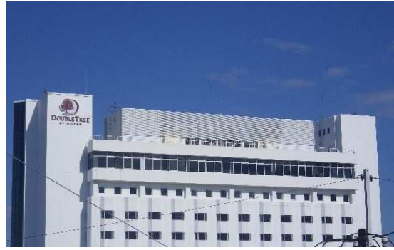
屋上の室外機は、目隠しルーバーを用いて遠景にも配慮
