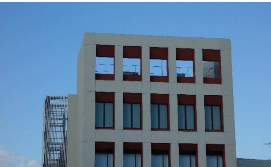
建物の意匠を崩さずに設備機器を隠した事例
