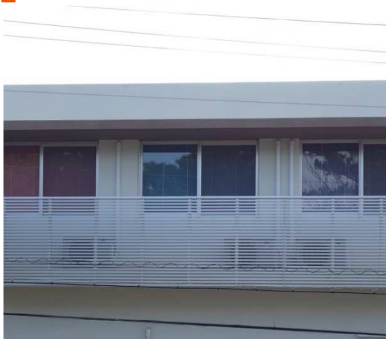
鋼製の横型ルーバーで室外機を隠した事例
