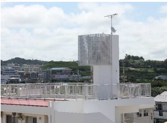
アルミルーバーで隠した事例
