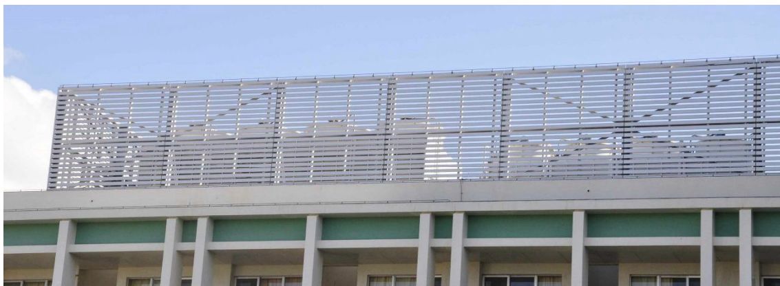
屋外設備をルーバーで目隠している事例【南風原町：沖縄県立南部医療センター・こども医療センター】
