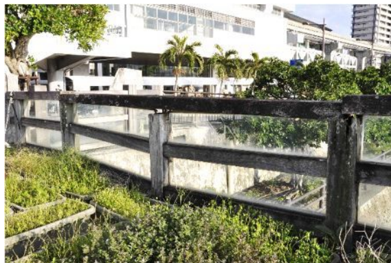
腐敗により、破損が見られる防護柵 【那覇市内】
