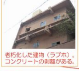
老朽化した建物(クラブホ)。コンクリートの剥離がある。
