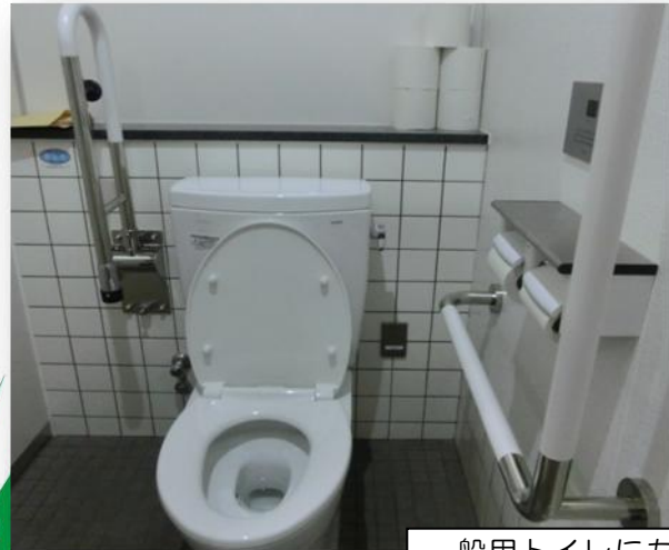
一般用トイレにも跳ね上げ手すりがついています。
