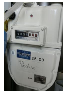
ガスメーター
