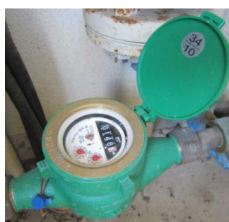
水道メーター
