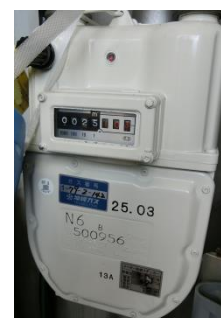
ガスメーター
