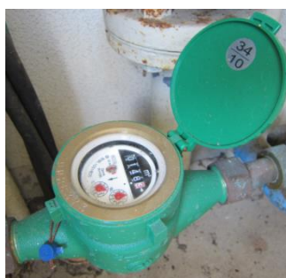
水道メーター
