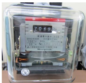
電気メーター
