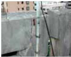
亀裂が入った屋上の手すり
