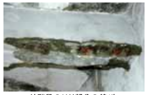
外階段のはり部分の錆び
