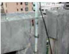
亀裂が入った屋上の手すり
