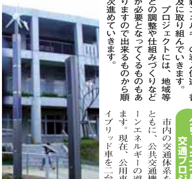
市立宇栄原小学校に設置されている太陽光・風力ハイブリッド発電設備
