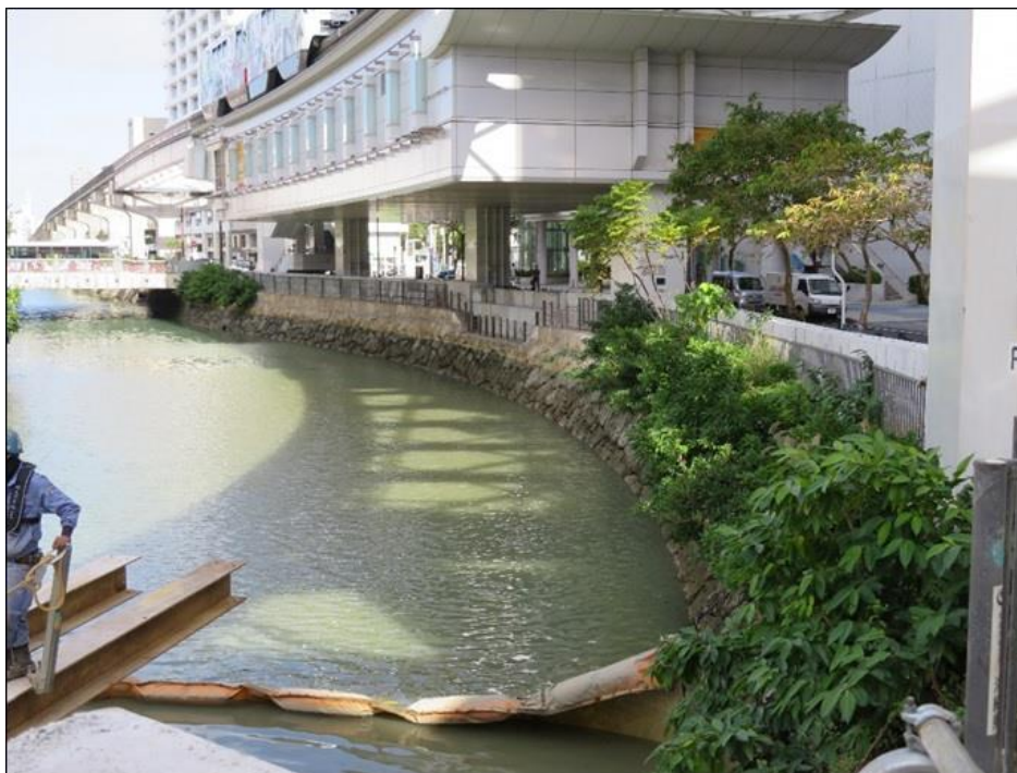
汚濁防止フェンス
