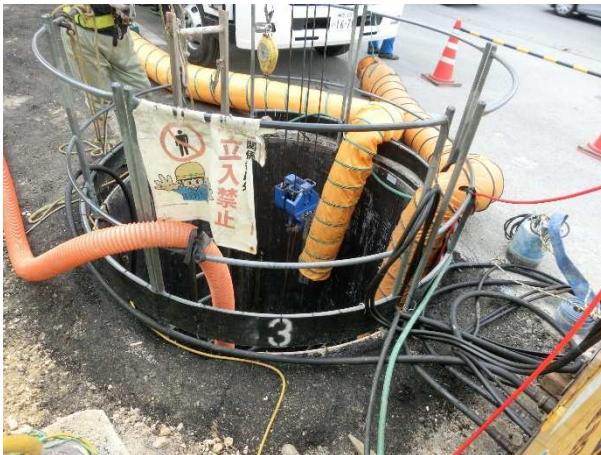
(写真-3 立坑天端 飛来落下防止及び浸水防止が必要)
