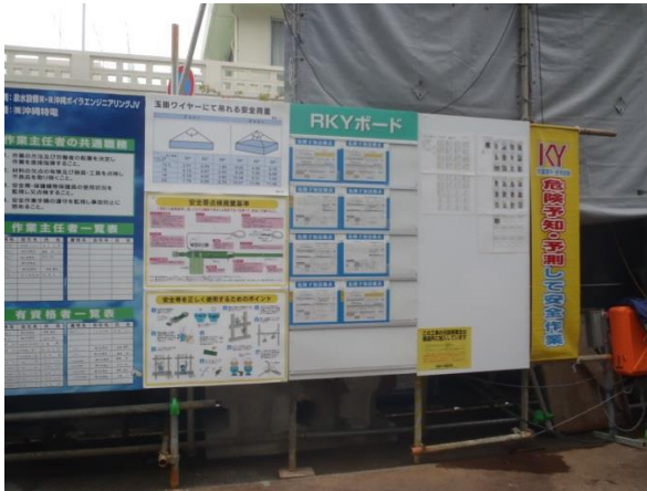
安全掲示板 建退共適用標識
