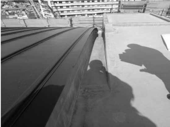
写真3 屋内運動場屋根とプール棟 屋根取り合い隙間
