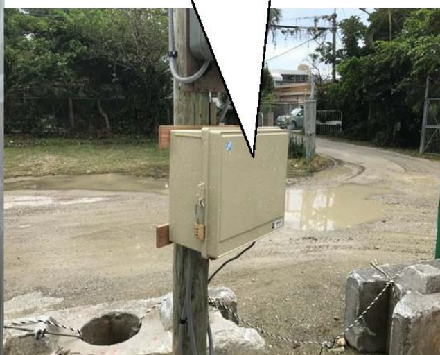
(写真－2 仮設分電盤)
