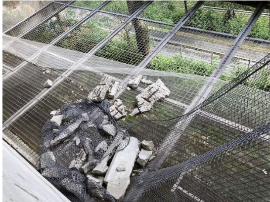
既存アマハジ下部（崩落）
