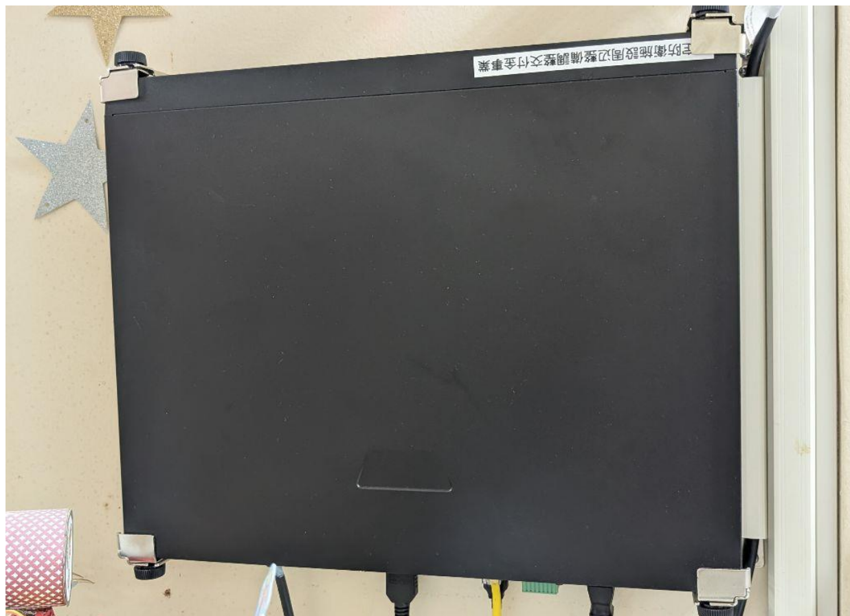
【モニター及び録画装置の状況】
