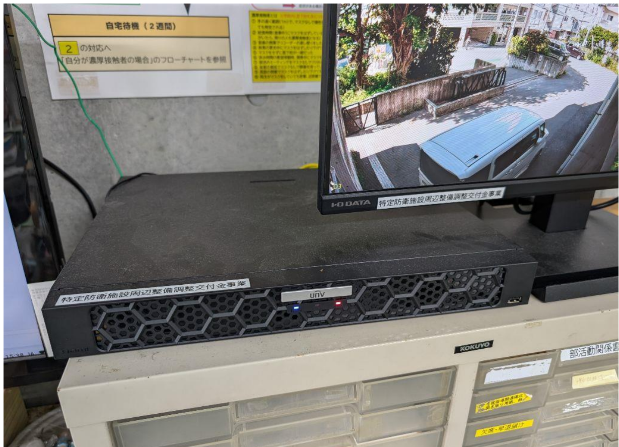
【モニター及び録画装置の状況】
