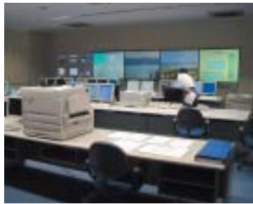
消防緊急情報指令システムは素早く火災現場を確認します
