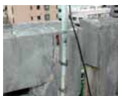
亀裂が入った屋上の手すり
