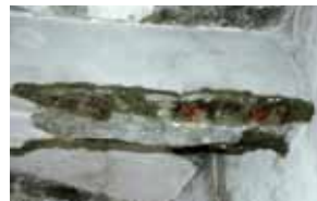
外階段のはり部分の錆び
